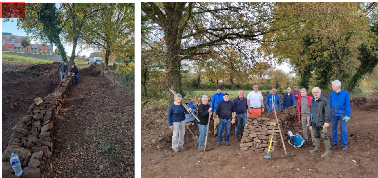
Mur de pierres sèches trouvées sur place Proche EPHAD – longueur de 300 m
